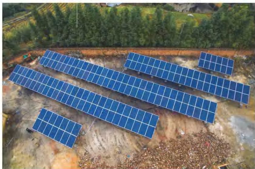
(双峰项目常汉村已建好的光伏电站航拍图)
